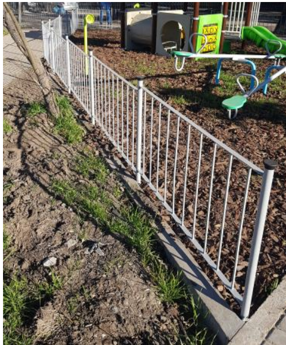
Reja para contención en sector de niños 1m de alto
