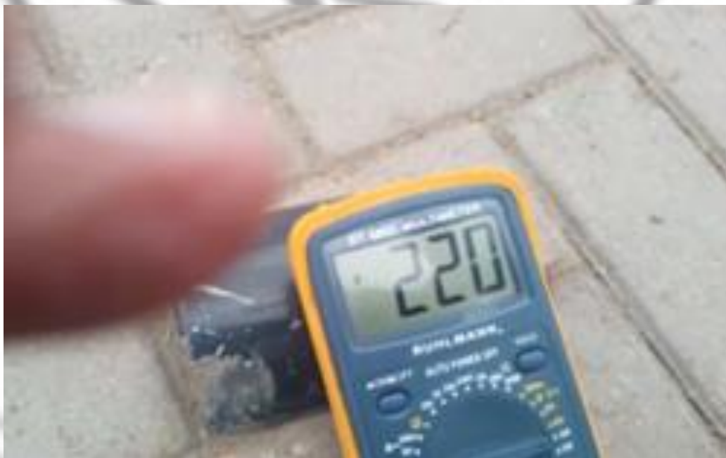
Medición de Fase en Luminaria
